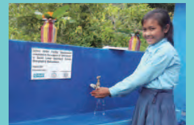
新しい給水設備で手を洗う女の子（ネパール）
