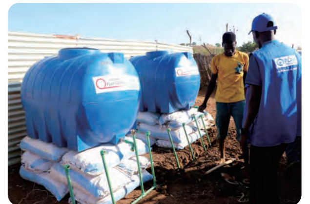
プランが設置した給水タンク
