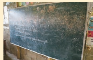
剥がれて老朽化した黒板
