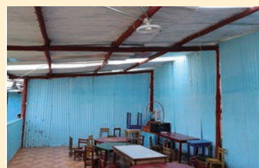
脆弱なつくりの食堂は雨漏りし窓もなく雨風をしのげない
