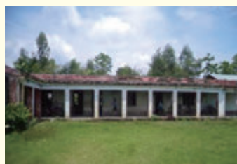
老朽化が激しく倒壊の恐れがあり、建て替えが必要な校舎
